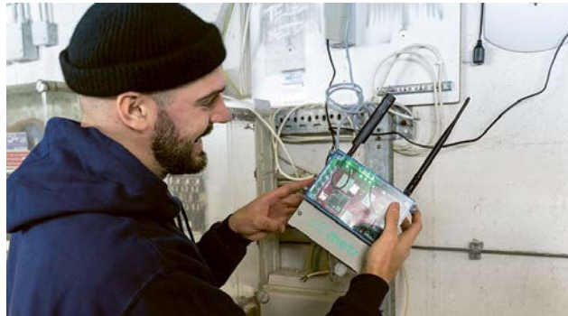
Durch die digitale Heizungssteuerung können wir die Anlagen effizient steuern.
